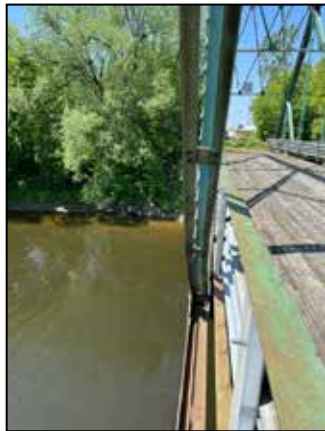
Plusieurs montants connaissent une déformation permanente
