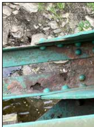
Une poutre triangulée avec corrosion très importante et perforée par endroit.
