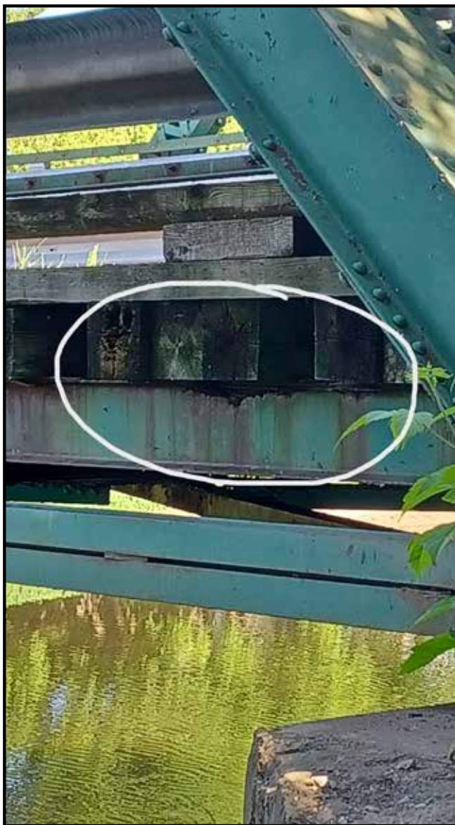
Le platelage, qui reçoit le tablier, est très rouillé
